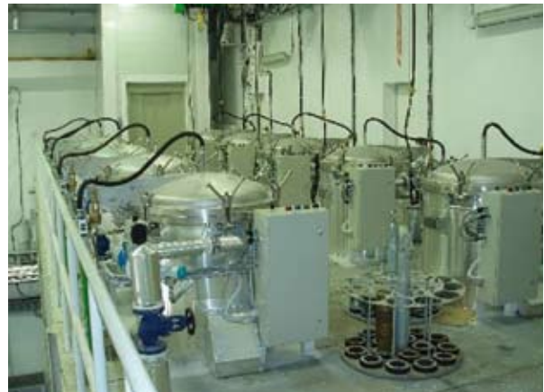
Fig. 6.1: Fusione del TNT con autoclavi presso l'impianto per l'eliminazione delle munizioni di Ankara (per gentile concessione NAMSA)
